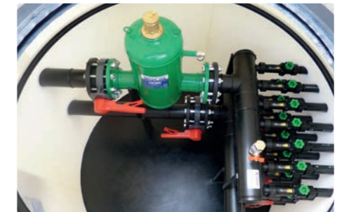
Verteilerschacht mit Mikroblasenabscheider
