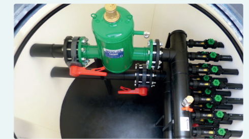
Verteilerschacht mit Mikroblasenabscheider
