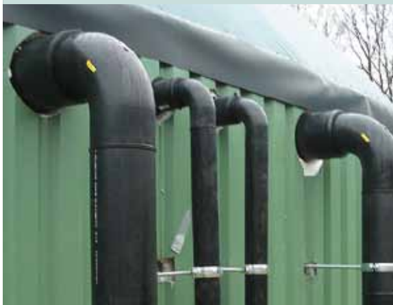
Abb. 3 – Rohrleitungen aus PE-el für die Biogasanwendung
