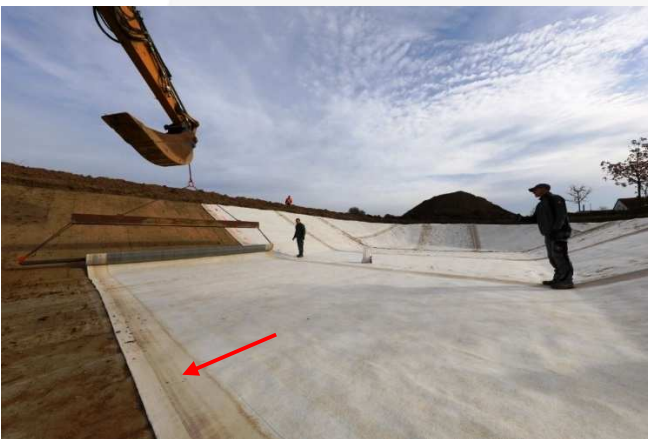
Längsseitig mit Bentonit eingestreuter Bereich als selbstabdichtende Überlappung, im Bild bräunlich gefärbt (zusätzlich durch roten Pfeil markiert)
