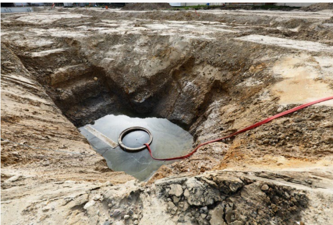
Baustellenansicht: das eingeschlossene Schichtenwasser sammelt sich in der Grube und wird abgepumpt
