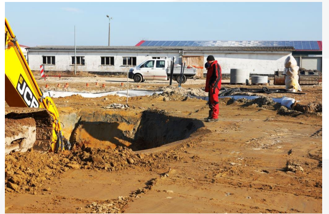
Baustellenansicht: Ausheben der Grube für die Tauchpumpe zur Entwässerung des abgesperrten Bereichs innerhalb der ringförmig ausgeführten wasserdichten Umschließung
