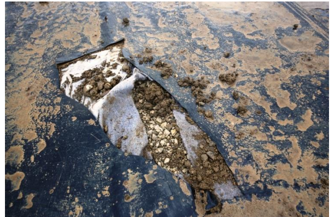
Baustellenansicht: Detailansicht der beschädigten KDB
