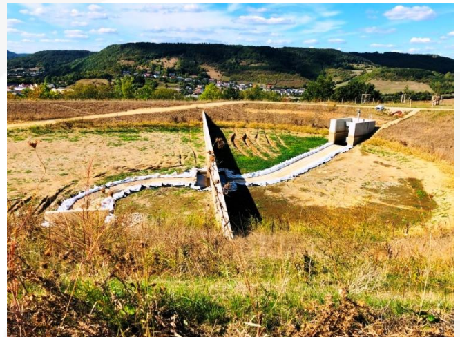
Baustellenansicht: Becken nach dem Schadensfall, Boden noch nicht abgetragen
