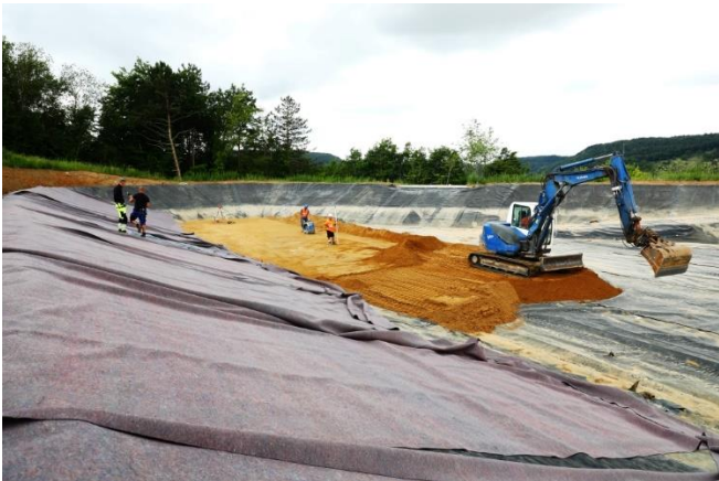
Baustellenansicht: Böschung: „alte“ KDB mit Schutzvlies überdeckt Beckenboden: Einbau der Bodenlage auf „alter“ KDB
