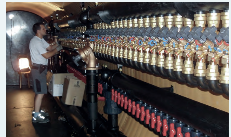
Verteilerkomponenten im Verteilerschacht
