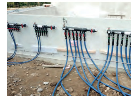
Sohleverteiler für die Kreisläufe
