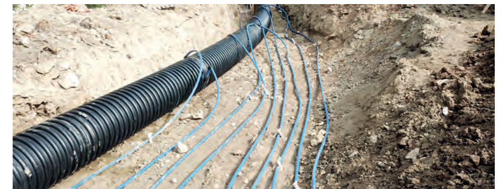
PKS-ThermPIPE® DN 800 mit angeschlossenen Fluidrohren da 50 mm
