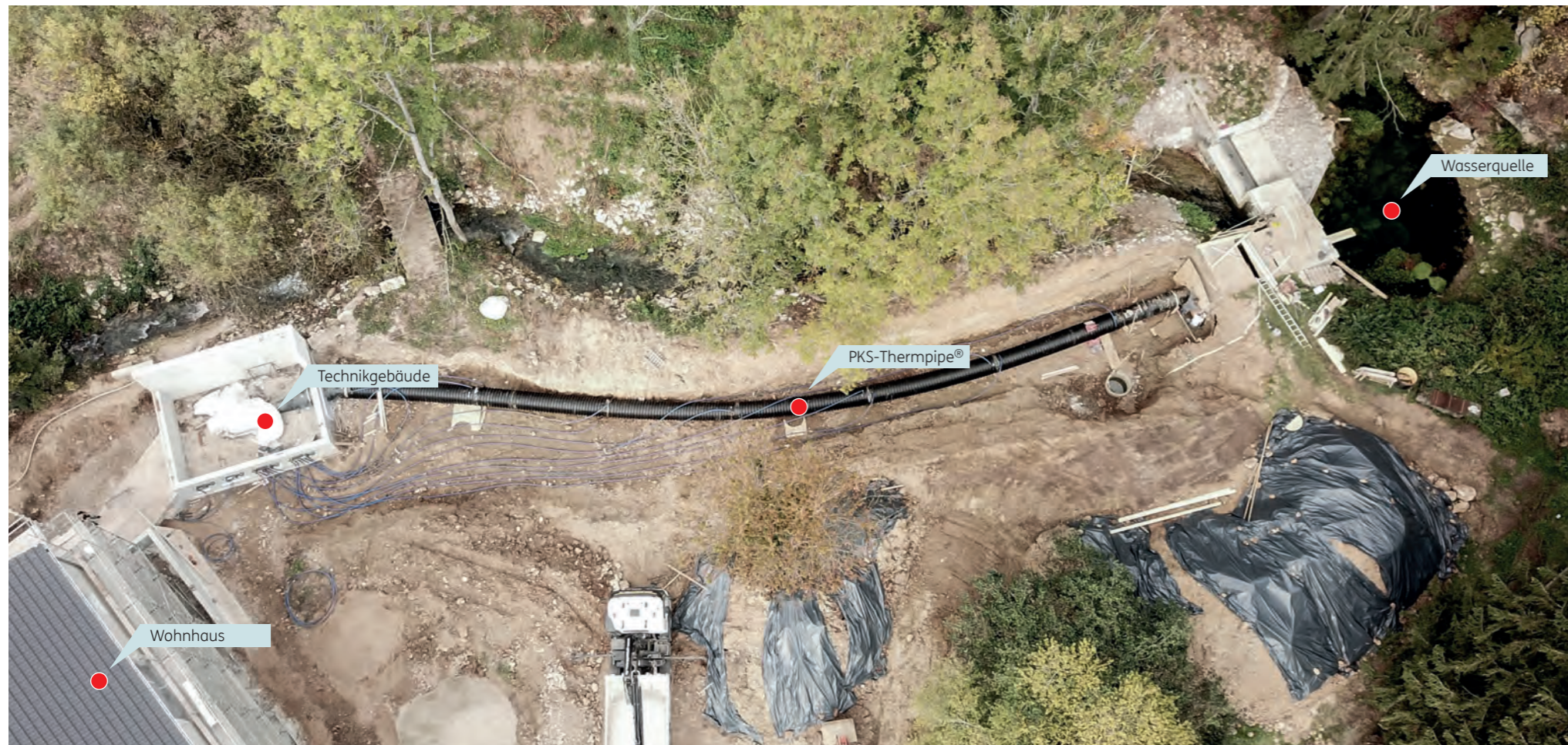
Übersicht Triebwasserkanal/PKS-ThermPIPE® DN 800 vom kleinen Blautopf (rechts) bis zur Turbine (links)
